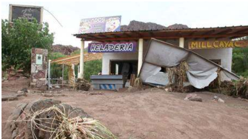
Foto 115 - Daños producidos por la tormenta del 17/12/2009 en Valle Grande. www.diariouno.com.ar
