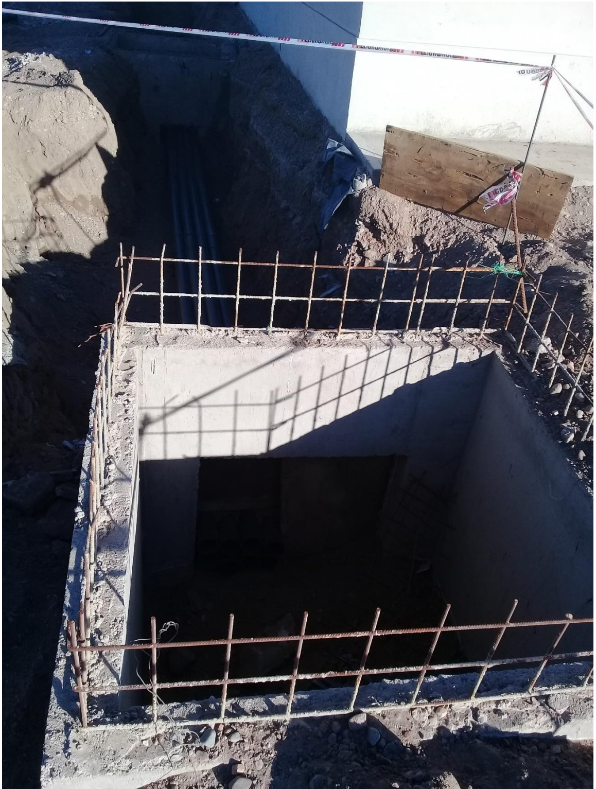
Ilustración 17 Cámara inspección eléctrica
